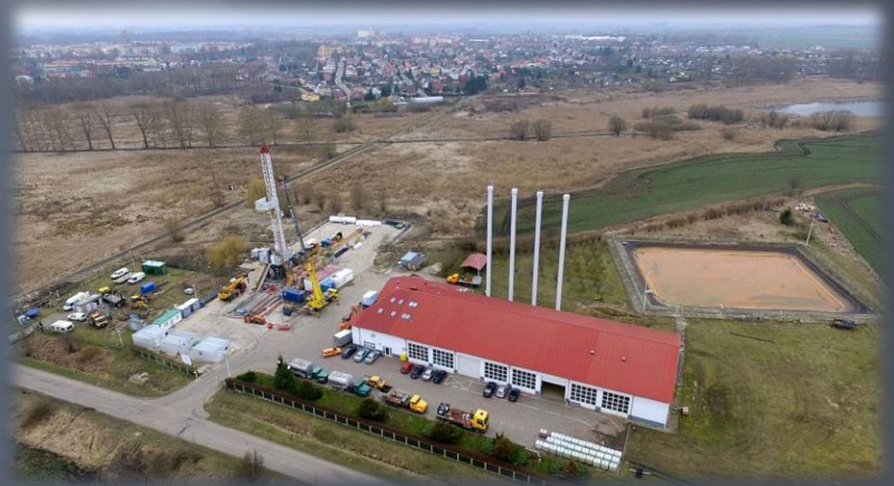
Ciepłownia geotermalna w Pyrzycach
